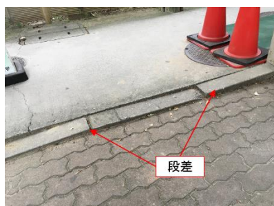
図4 コース中の段差
